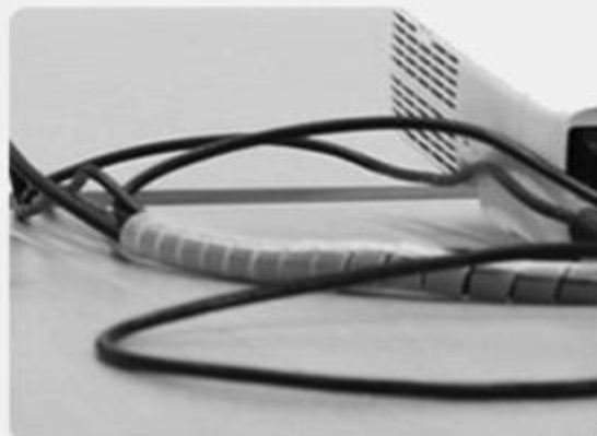
剥き出しの配線コードが 汚らしい
